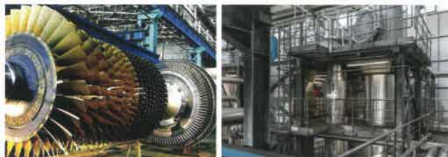
ガスタービンと焼却炉
